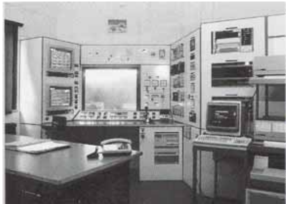
Prüfzimmer im Motorenprüfstand. Hier werden die Messdaten, welche vom Prüffeld ins Prüfzimmer geleitet werden, angezeigt und zum Teil laufend aufgezeichnet. Durch das Fenster wird der „Prüfling“ ständig beobachtet.
